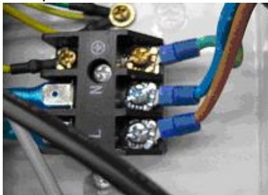
Figure 9: Bornes de branchement au réseau électrique.
